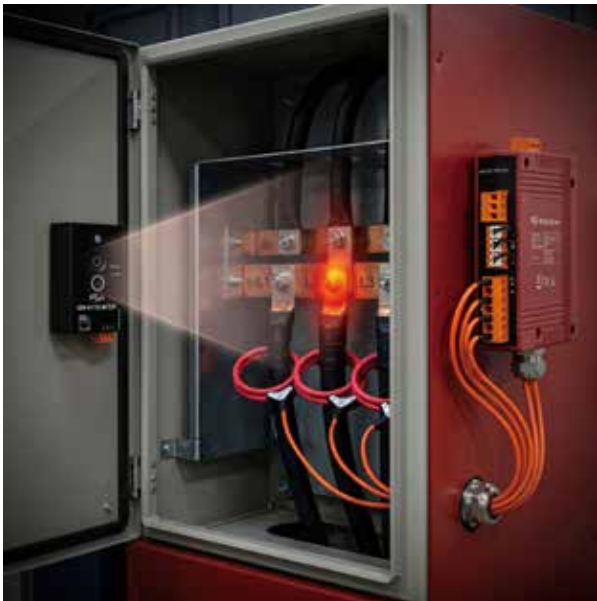
▲ 圖四 | 高壓配電盤熱點監測 透過非接觸式熱成像監測配電盤接點溫度，即時發現異常熱點，降低電氣火災與停機風險。
