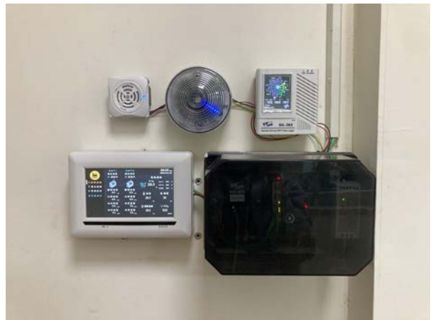
▲ 整合監控系統加上 TPD 與現場告警機制
