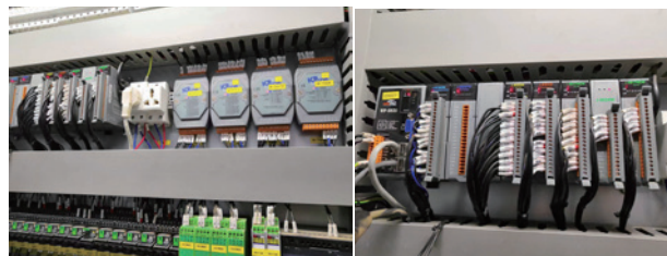
▲ 燃气发电控制系统
