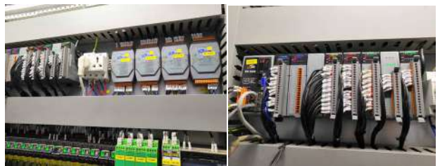
▲ 燃氣發電控制系統
