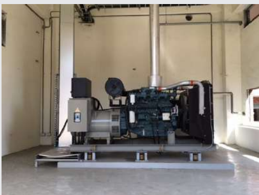
▲ 圖三、發電機監控
