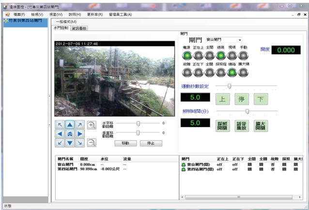
▲ 安研科技 遠端閘門圖控系統
