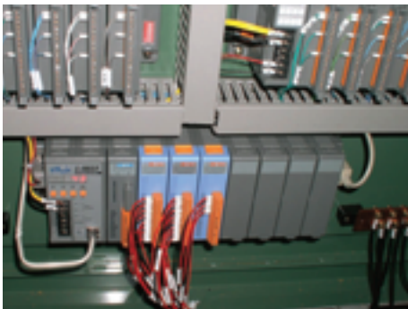
圖三、德基大壩儀器更新案量測主機實體圖
