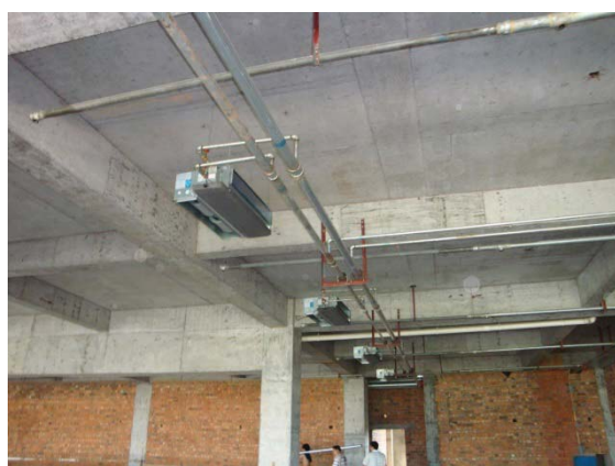
▲ 圖二 風機盤管及與其連結的冰水管線
